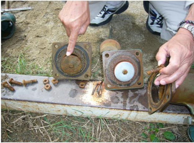
⑦既設手動式ポンプ逆止弁確認 管内水密部分のパッキンが破断 水密が取れ無い為、新品交換
