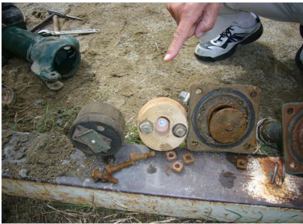
⑧吸い込み口側パッキン確認 パッキンに破断を確認したので ポート研磨しパッキン交換
